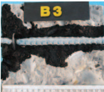
Schwundrißbildung gefährdet die Wasserundurchlässigkeit bei Ankerstäben...
